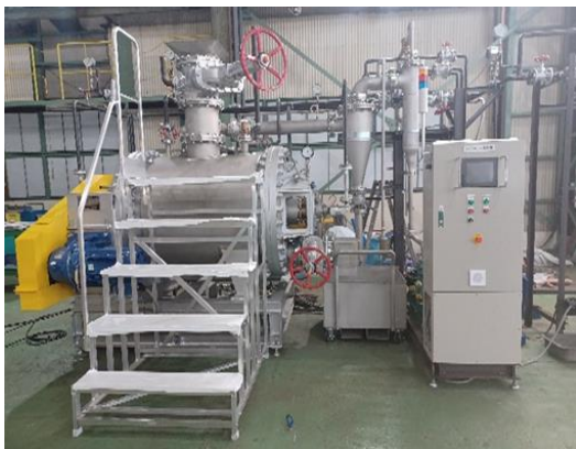
〔清本鉄工(株)食品残渣リサイクルプラント〕
